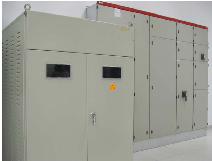
图：IDC 服务器机房配电柜和输入变压器，左边突出部分为变压器
